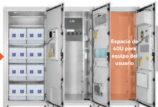
Gabinete de baterías
