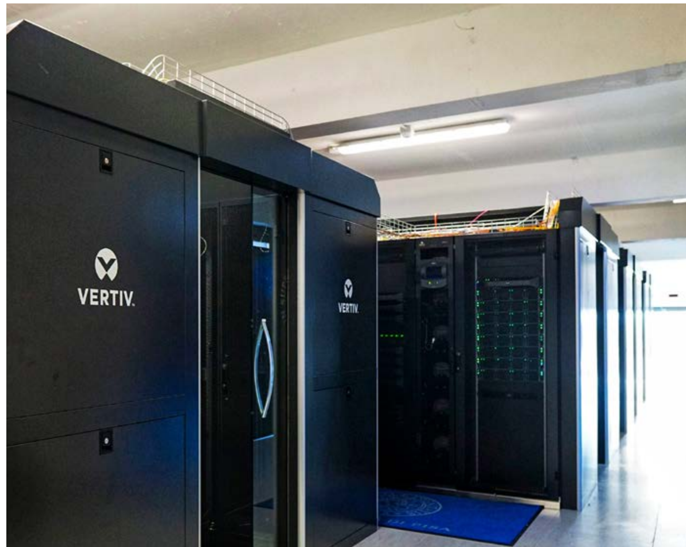
A Universidade de Pisa emprega soluções de alta densidade da Vertiv, incluindo refrigeração líquida para aplicações diretas no chip e sistemas de alimentação de energia de alta densidade, para a expansão de seu data center híbrido e ecológico.
