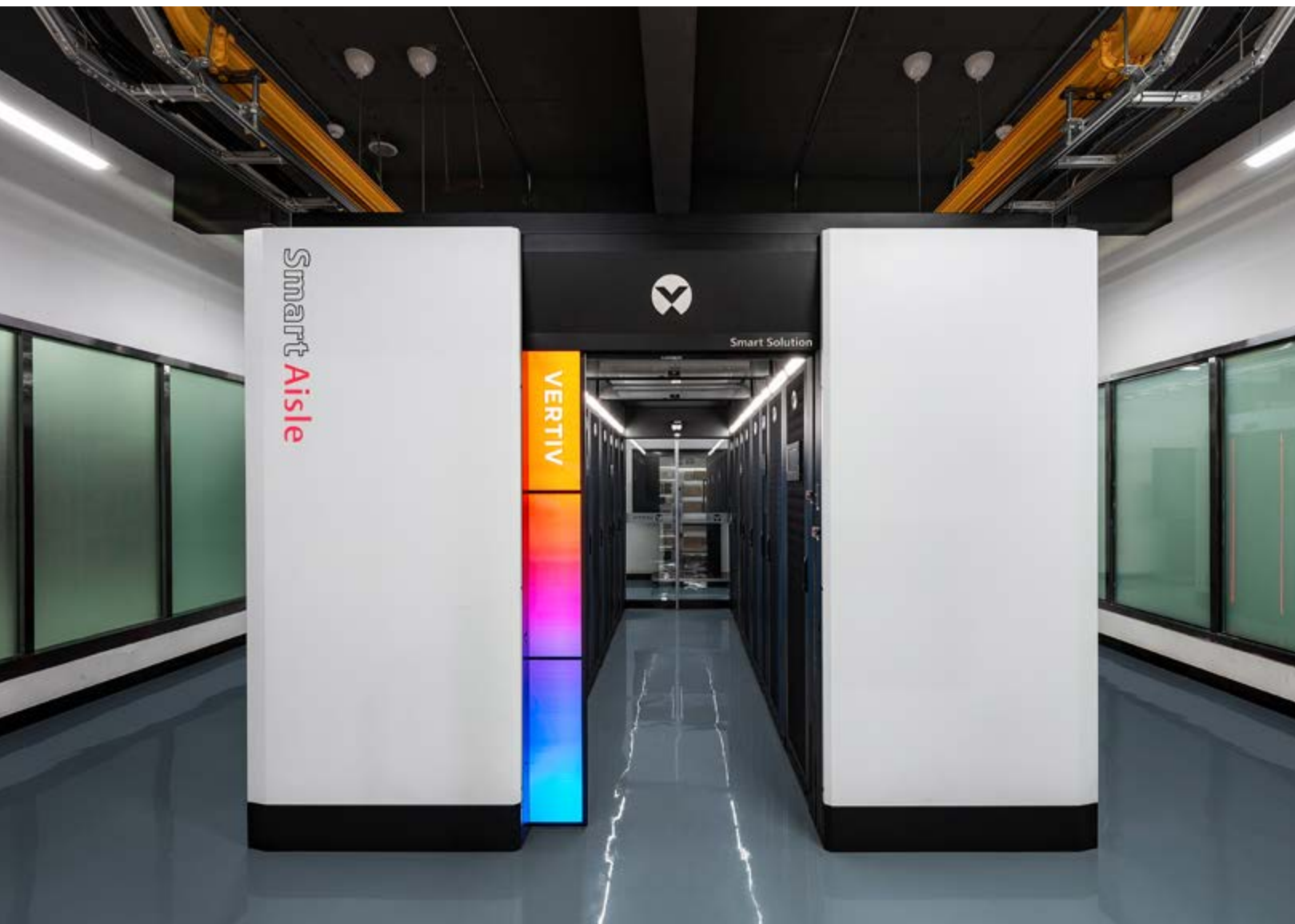
O Vertiv™ SmartAisle™ 3, uma solução de data center micromodular habilitada por IA, é uma peça central do centro de experiência do cliente e academia em Shenzhen, China.
