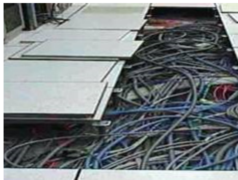
Typisches Rechenzentrum mit Netzkabeln und Leerrohren
