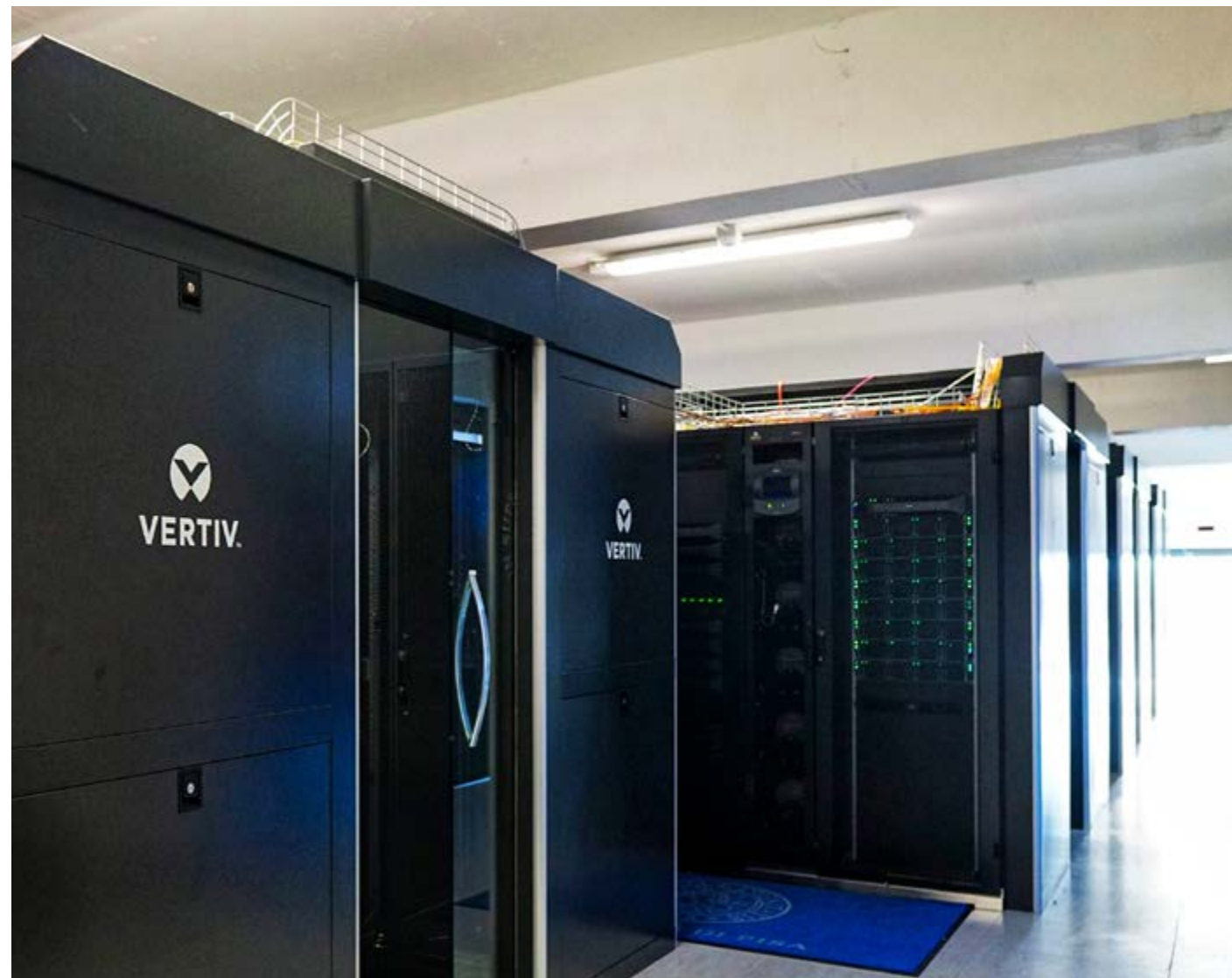
L'Università di Pisa impiega le soluzioni Vertiv ad alta densità, tra cui il raffreddamento a liquido per le applicazioni dirette sui chip e i sistemi di alimentazione ad alta densità, per l'espansione del proprio data center ibrido e sostenibile.
