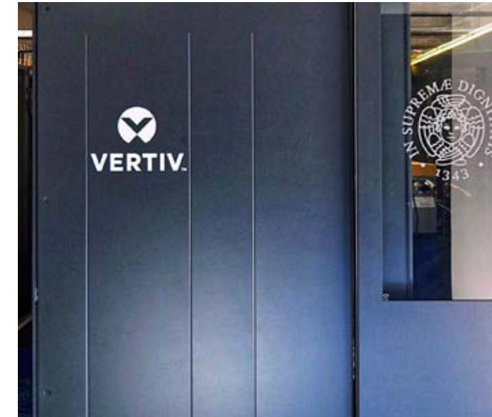
Tra i principali vantaggi offerti dalle soluzioni Vertiv vi è l'implementazione del raffreddamento a liquido nei data center raffreddati ad aria già esistenti.
