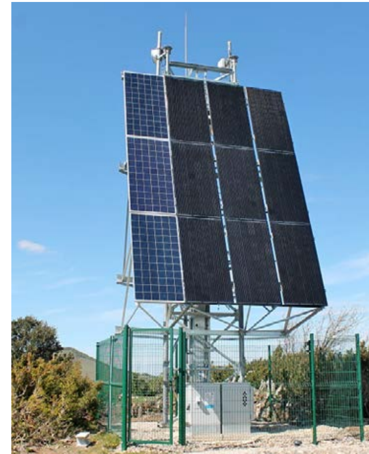
L'impiego dell'energia fotovoltaica offre la versatilità necessaria per installare un ripetitore in Francia, in una località appropriata.
